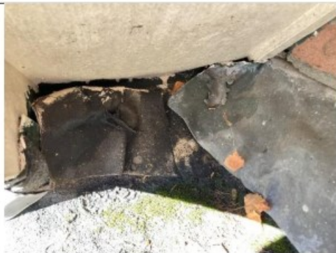
Loodwerk op het platte dak (foto hierboven) wat de oorzaak van de lekkage is in één van de slaapkamers op de begane grond (foto's rechts)
