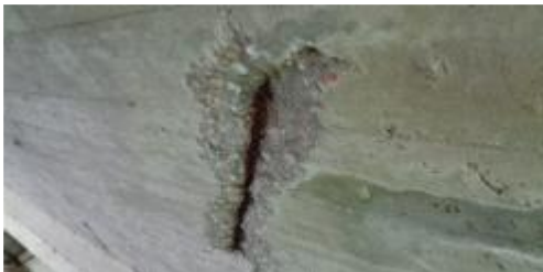
Afgedrukt beton onderzijde brug
